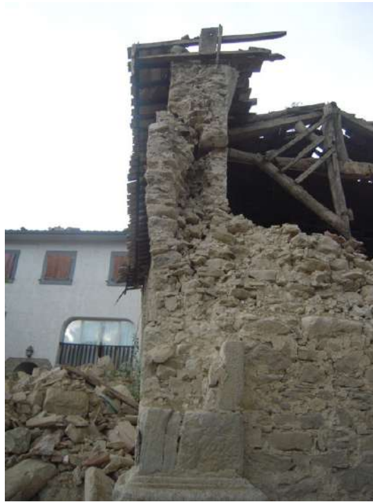
Fig. 1. Esempio di disgregazione della tessitura muraria, chiesa dei Santi Lorenzo e Flaviano, Amatrice, 2016.
