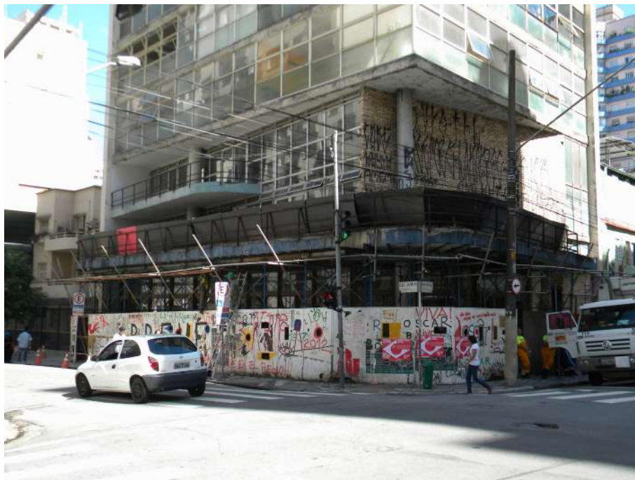
Sede do Instituto dos Arquitetos do Brasil, São Paulo, antes do restauro. (Foto: Ary França, 2014. Coleção: Instituto de Arquitecos de Brasil)
